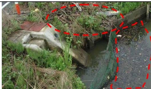
写真 34：取水部周辺の土砂やゴミの堆積
