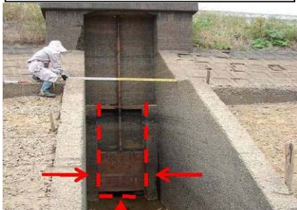
写真 33：ゲート周りの漏水
