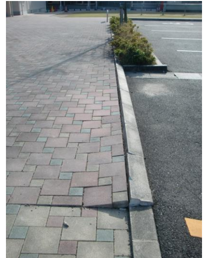
地震で浮き上がった前庭のブロック(北条小学校)
