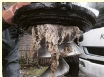
ポンプに詰まった異物
