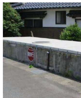
フタを整備した防火水槽 (西新田場)
