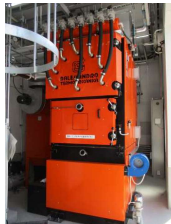
バイオマスボイラー(B&G 海洋センター設置)
