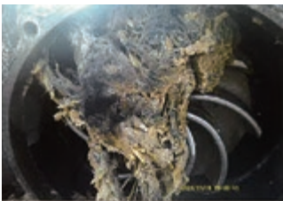
ポンプに詰まっていた不織布(11月)
