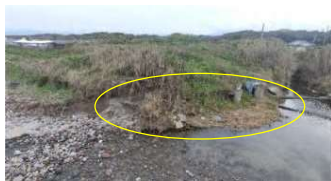
護岸崩壊の状況
