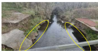
護岸崩壊の状況
