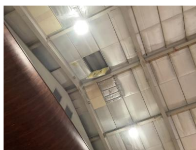
大栄小体育館断熱材剥がれ等
