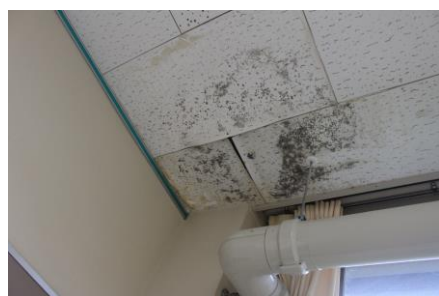
北条小北校舎雨漏り
