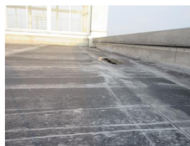
大栄中管理棟屋上防水劣化等
