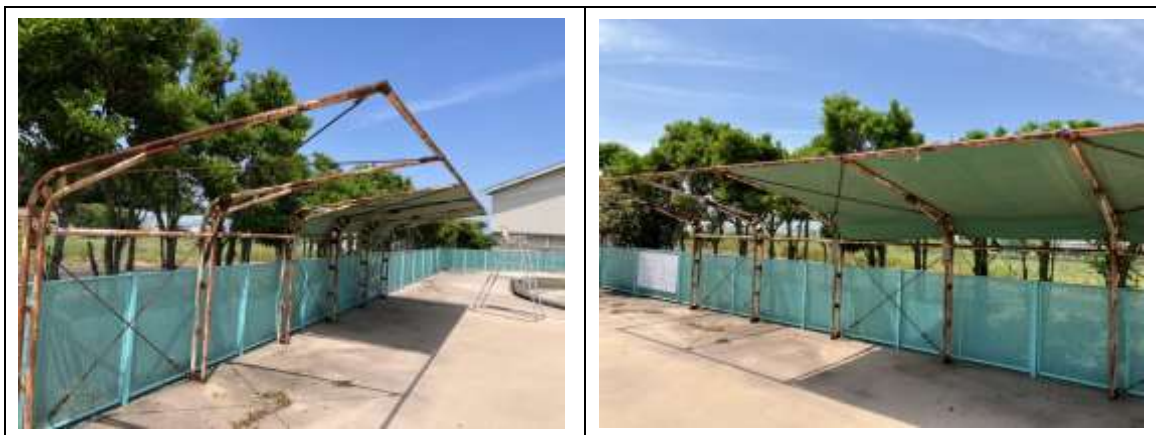
劣化した日よけ。フェンスも低く児童が盗撮される危険性も。
