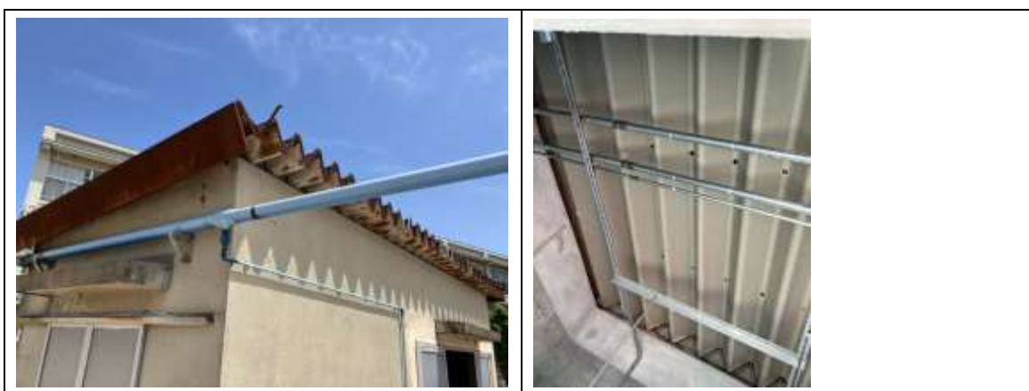
機械室の屋根（外側）は劣化が見られ補修が必要。
