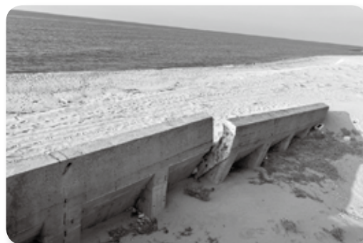
波で壊されたブロック
