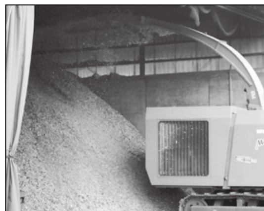
ボイラーの燃料となる木片
