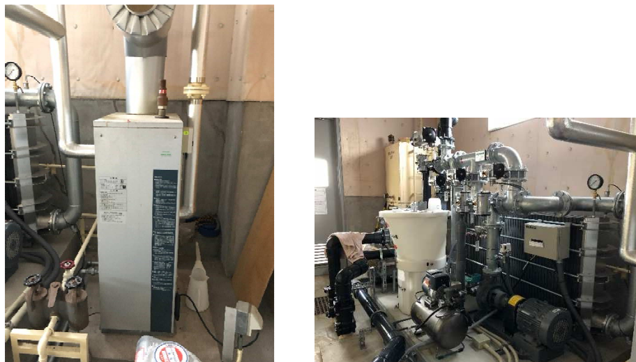
図 4-4 既設ボイラーとプールろ過器
