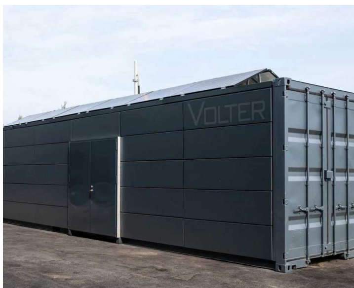
図 5-8 40 フィートコンテナ内への設置事例（発電機等を収納）
