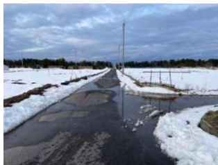
東園西稲場線：路面滞水状況
