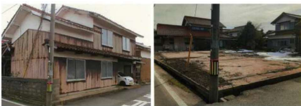
危険空家の除却
