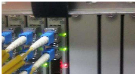
光ファイバーのセンター設備
