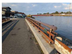
前川橋の高欄腐食
