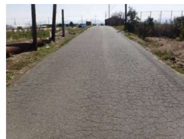
町道大谷運動場横線:舗装劣化状況
